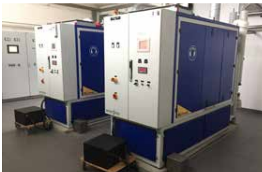
Abb. 2: BHKW zur Verstromung des Faulgases
