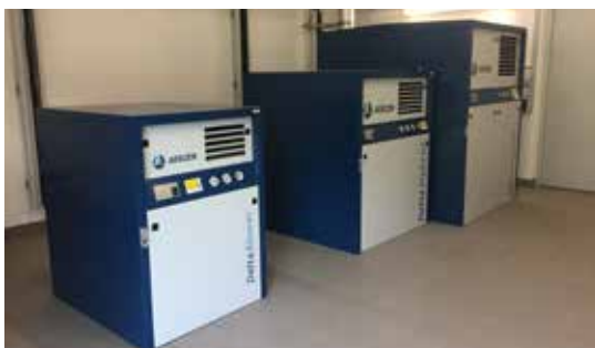
Abb. 3: Neue Verdichterstation mit abgestuften Gebläsen
